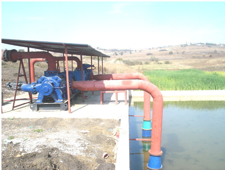
Fig.40.. Ujëmbledhësi (rezervuari) në fushën e Sibofcit JP me stacionin e pompave për heqjen e ujit.
